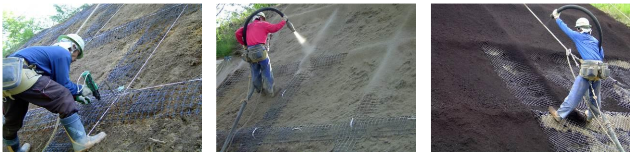
写真-2 施工状況 (左: ジオグリッド設置、中: 改良土吹付、右: 植生基材吹付)
