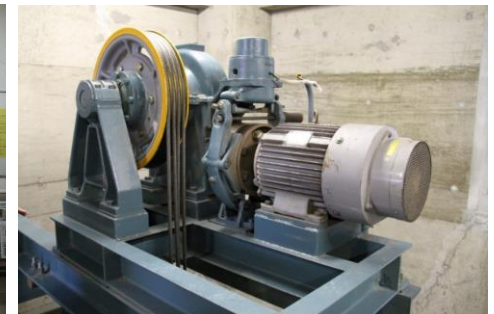
写真2 事故機巻上機
