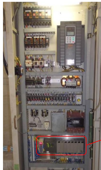
写真5 事故機の制御盤
