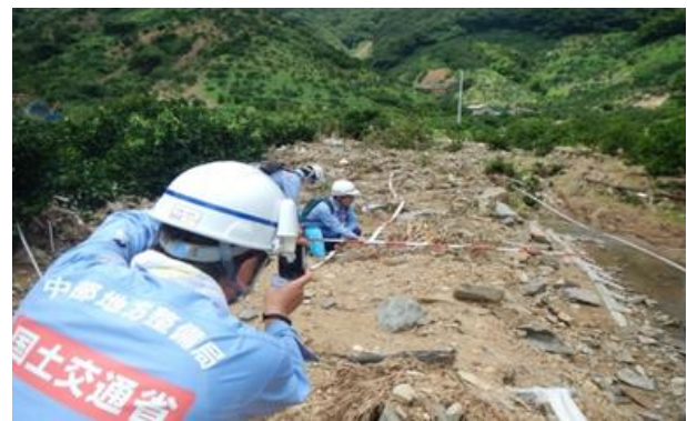
被災状況調査（中部地方整備局）
