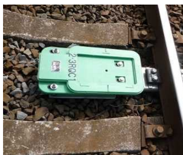
電路設備 (自動列車停止装置(ATS))
