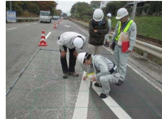
ひび割れ確認
