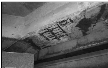
栈橋上部工の鉄筋腐食、コンクリート剥離
