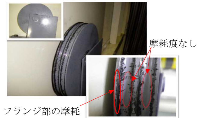
写真4 上げ戸滑車の状態 (事故機)
