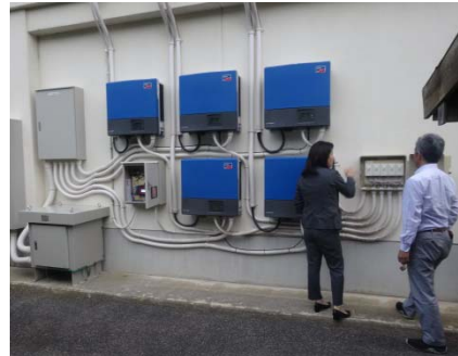
海士中学校における太陽光発電設備
