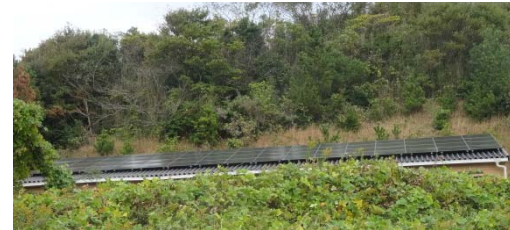
携帯用アンテナと非常用電源の確保
