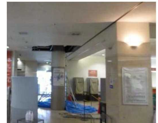
病院における天井の損傷
