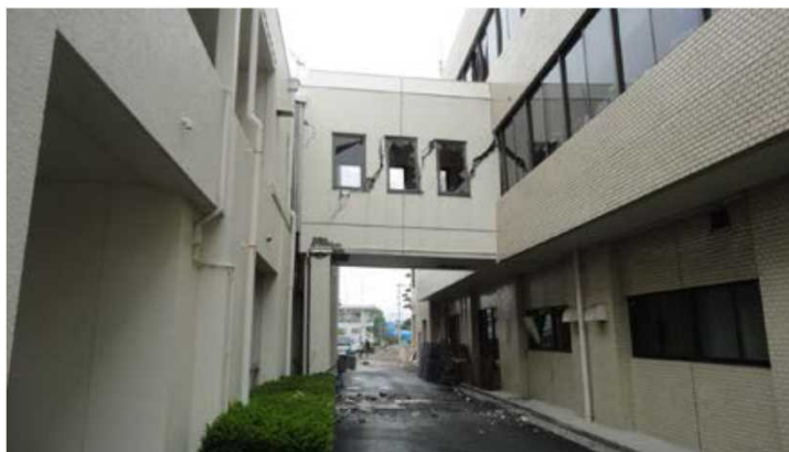
庁舎における構造部材の損傷
