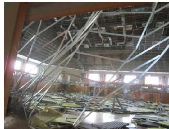
体育館における天井の損傷
