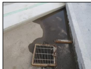
雨水が滞留している例
