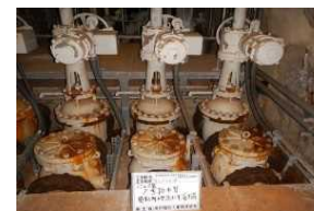
青函トンネル排水設備
