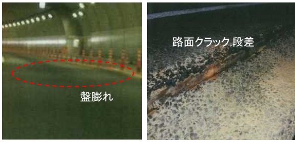
《トンネル変状》
