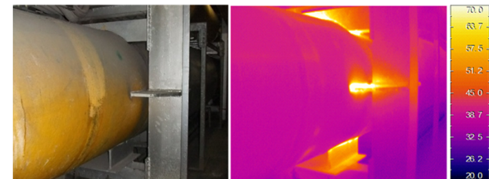
配管固定部からの熱損失
