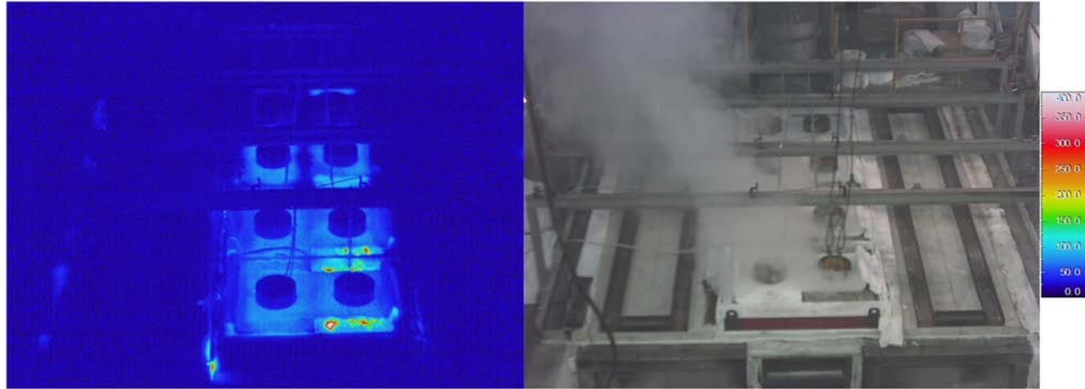
a) 熱映像、全体写真(仕様1②脱落直前)
