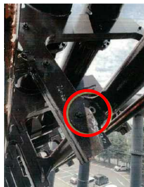
写真4 折損したボルトの設置箇所
