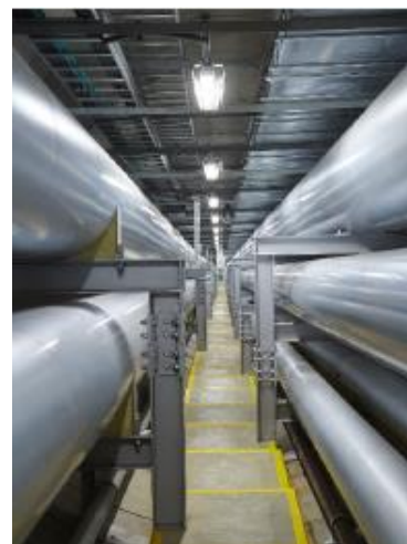
熱導管・自営電力線
