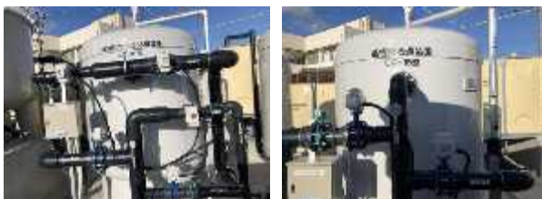
図14 除マンガン除鉄ろ過装置（左）、活性炭ろ過装置（右）
