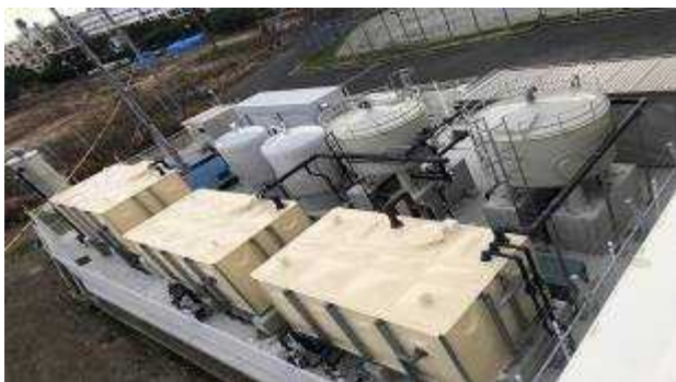
図12 地下水浄水施設（上空からの全景）
