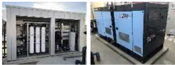
図15 UF膜及びRO膜（左）、非常用発電機（右）
