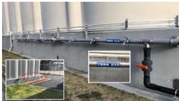
図16 災害時の給水口
