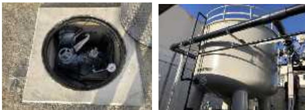
図13 深井戸（左）、除濁ろ過装置（生物処理）（右）
