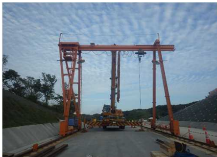
門型クレーン
