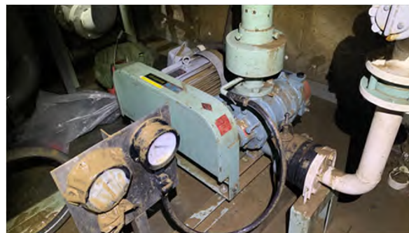
浸水した曝気ブロー
