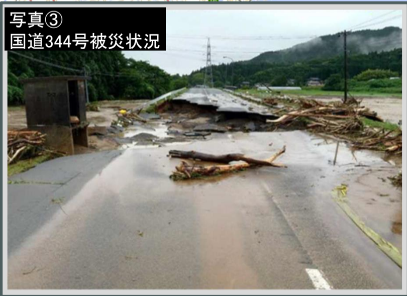
被災による通行止め区間 240729_0700 時点
