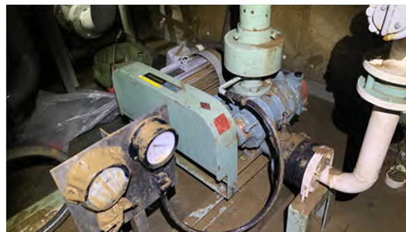
浸水した曝気ブロー
