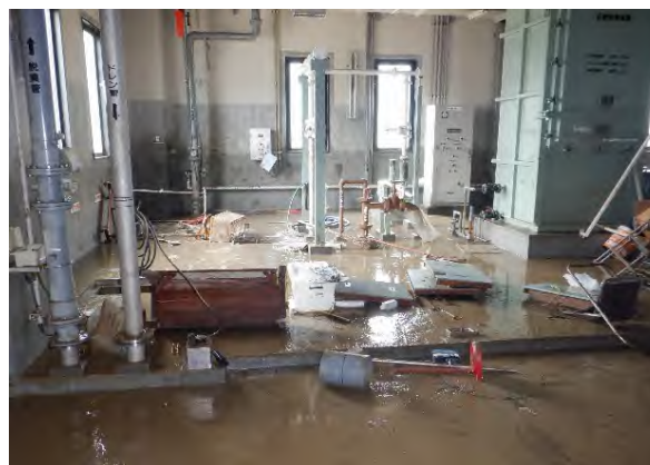
浸水した浄化センター内
