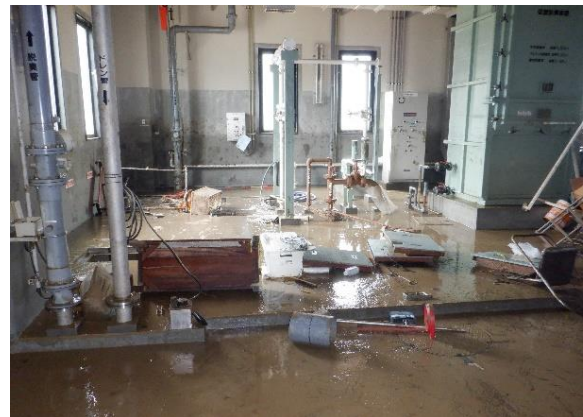
浸水した浄化センター内
