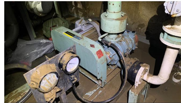
浸水した曝気ブロー
