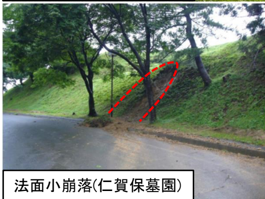
法面小崩落(仁賀保墓園)
