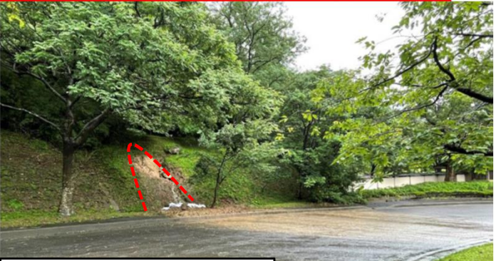
法面小崩落(仁賀保墓園)
