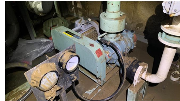
浸水した曝気ブロー
