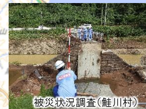
被災状況調査(鮭川村)
