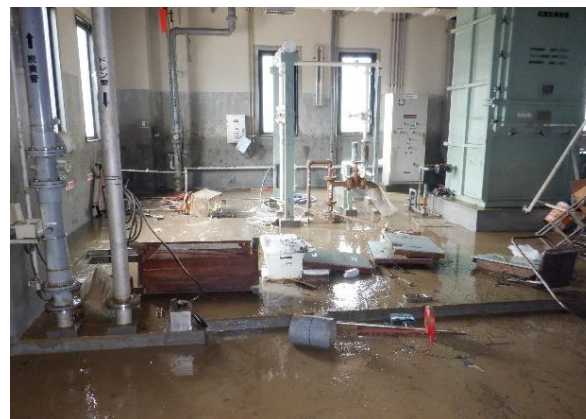
浸水した浄化センター内
