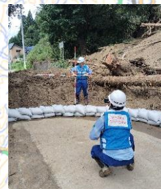
被災状況調査(真室川町)
