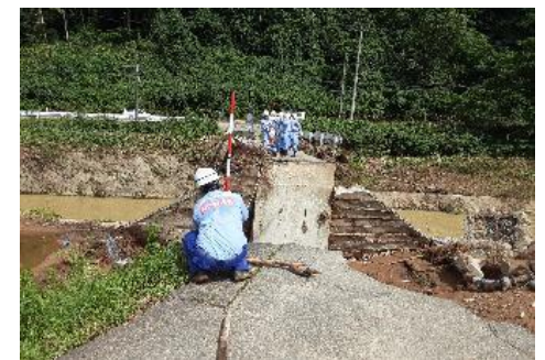
被災状況調査(道路) (山形県鮭川村)
