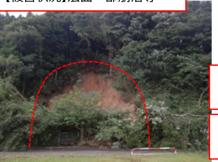
法面一部崩落(東平田さくら公園)
