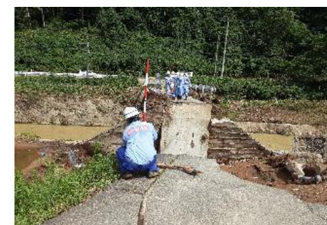
被災状況調査(道路) (山形県鮭川村)
