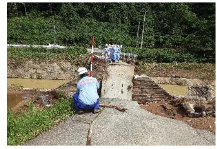
被災状況調査(道路) (山形県鮭川村)
