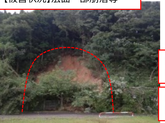
法面一部崩落(東平田さくら公園)
