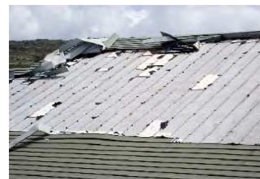
管理棟屋根が破損
