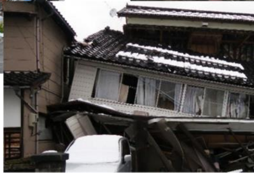
木造建築物の倒壊状況（穴水町）
