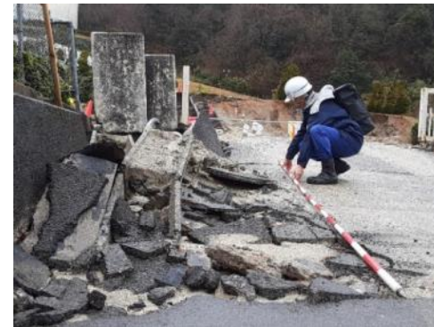
岩屋浄水場の被災（七尾市）
