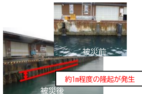
船だまりの被害状況
