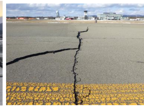
能登空港の被災（穴水町）
