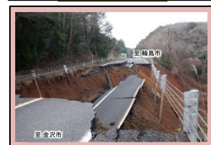
写真⑤ 能越自動車道の道路崩壊
