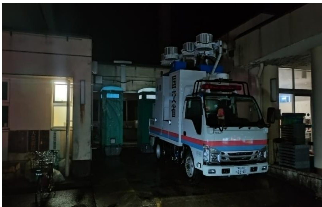
旧本小学校への電源供給
