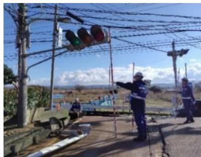
道路の被災状況調査 (石川県内灘町)
