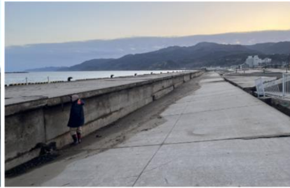
輪島港の被災（輪島市）
