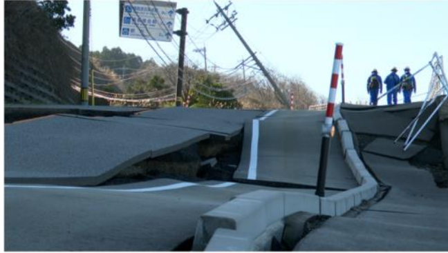
国道249号道の駅千枚田付近（輪島市）
