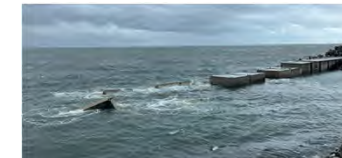
施工中の護岸の転倒
