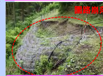
天ヶ城公園（園路崩落）
