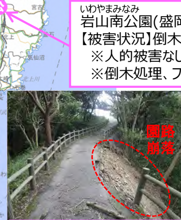
久峰総合公園（園路崩落）
