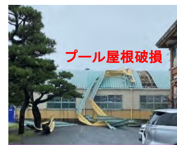
霊丘公園（プール屋根の破損）
