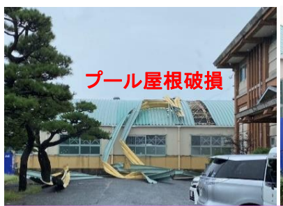
霊丘公園（プール屋根の破損）
