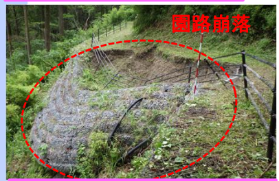
天ヶ城公園（園路崩落）
