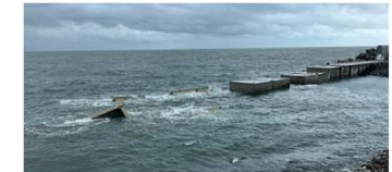
施工中の護岸の転倒
