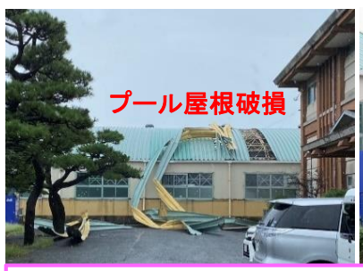
霊丘公園（プール屋根の破損）
