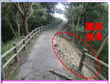
久峰総合公園（園路崩落）
