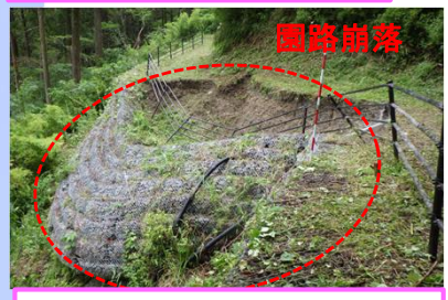
天ヶ城公園（園路崩落）
