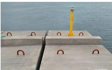
離岸堤ブロックの傾斜
