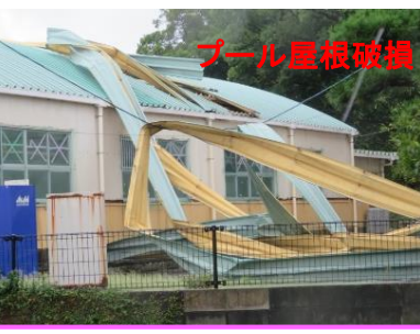
霊丘公園（プール屋根の破損）
