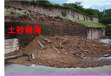
湯河原町総合運動公園 (土砂崩落)
