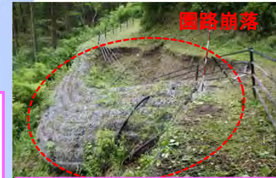
天ヶ城公園 (園路崩落)
