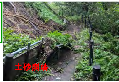
吾妻山公園 (土砂崩落)
