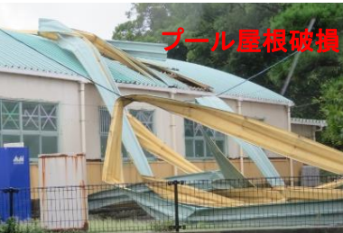
霊丘公園(プール屋根の破損)
