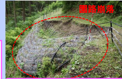
天ヶ城公園 (園路崩落)
