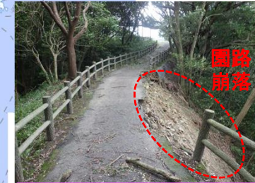
久峰総合公園 (園路崩落)
