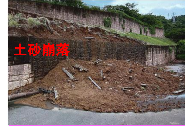
湯河原町総合運動公園 (土砂崩落)
