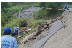
H30 北海道胆振東部地震被災状況調査(北海道厚真町)
