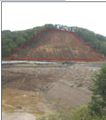
【勇払東部地区】厚真ダム ダム左岸法面崩壊
