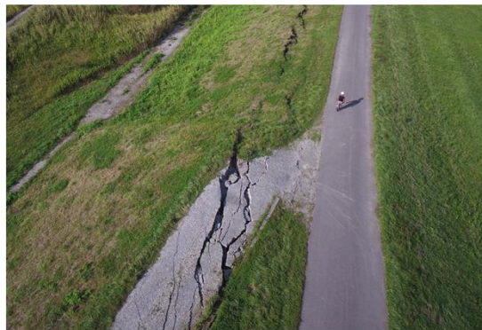
堤防の被災状況(亀裂)【9月6日】
