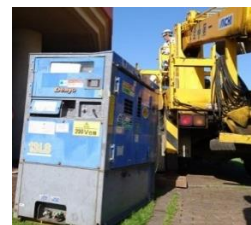
▲ 非常用電源装置
