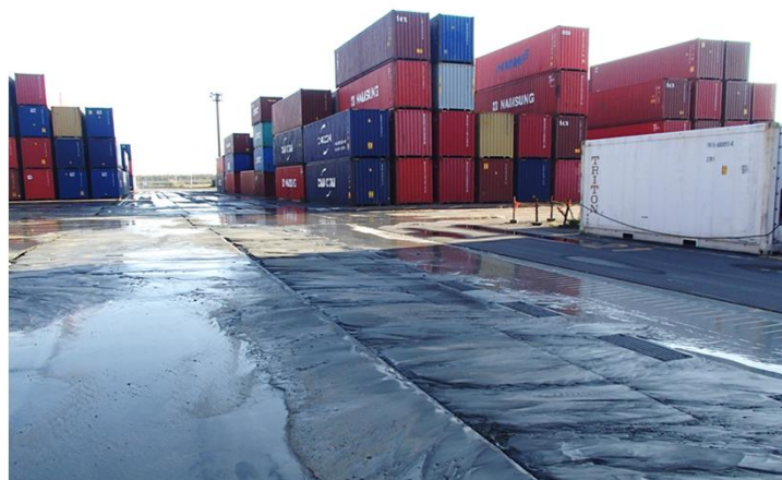
コンテナヤードの液状化
