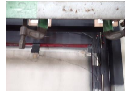
③ 試験体No.7 非加熱面の戸のけい酸カルシウム板と枠の隙間で赤熱確認→ビス留めから押さえ金物で周囲を軽く固定する程度に変更したことで、固定度が弱くなり変形が発生し枠との間に隙間が発生したこと、及び、保護材なしとしたことが原因
