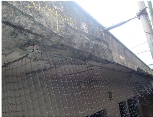
屋上庇 鉄筋露出
