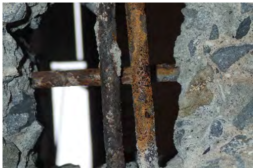
バルコニー下面 鉄筋腐食状況
