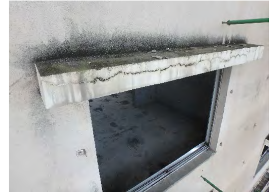
窓庇 ひび割れ
