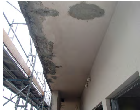
屋上庇 鉄筋露出
