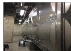
耐震性貯水槽
