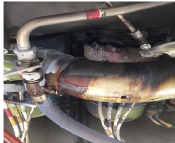
APU NO. 2 発電機
