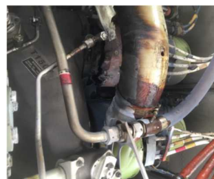
発電機冷却ダクト
