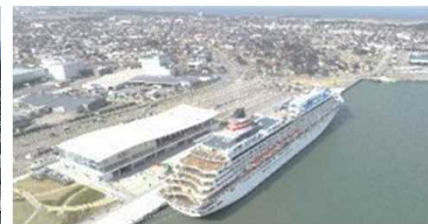
船舶への陸上電力供給
