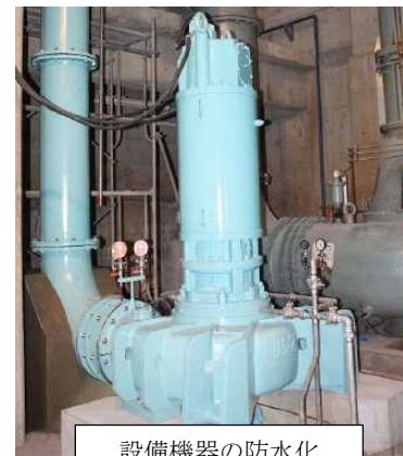
設備機器の防水化 (耐水型モーター)
