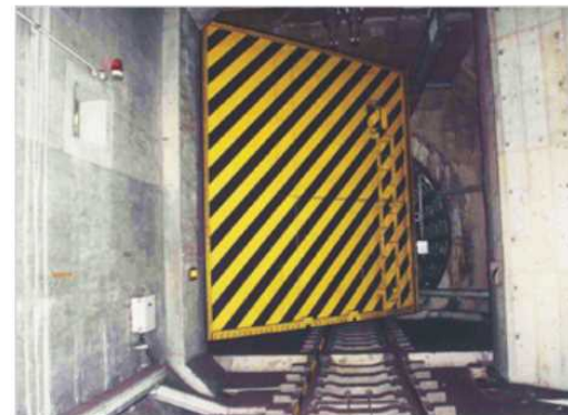
トンネル内防水ゲート
