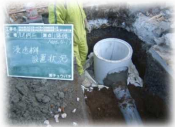
雨水浸透ます
