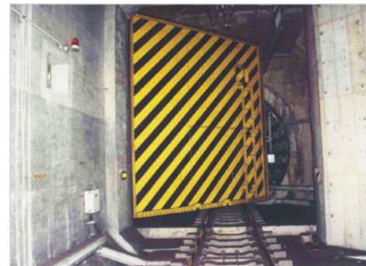
トンネル内防水ゲート
