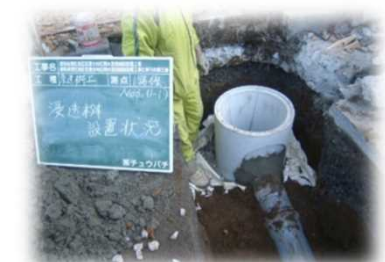
雨水浸透ます
