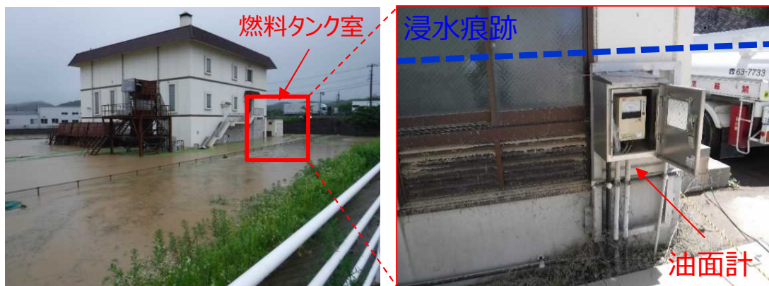
施設内への浸水はなかったものの、屋外に設置していた燃料移送ポンプの油面計が浸水により停止し、運転ができなかった。
