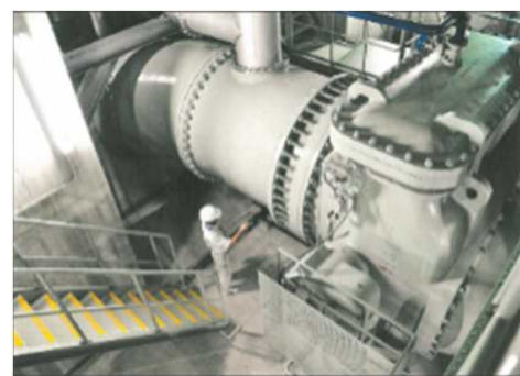
雨水ポンプの整備
