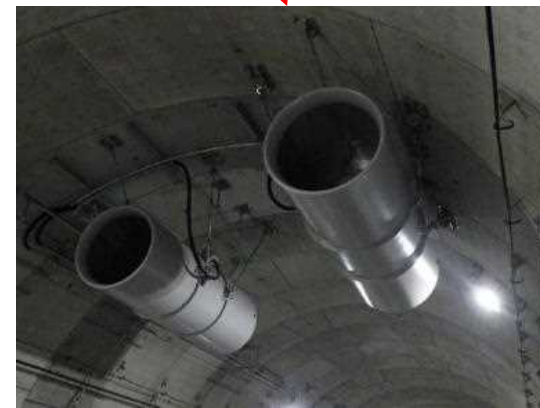
排煙設備の設置事例
