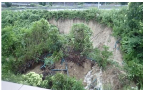
平成30年7月豪雨 のり面崩落 (7号北神戸線 藍那出口)
