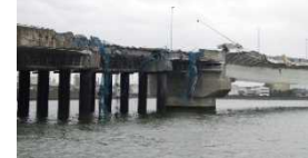
横浜南本牧はま道路の損壊状況
