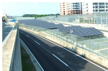
道路での再エネ発電量：約1.3万MWh (道路管理の消費電力の約0.4%)
