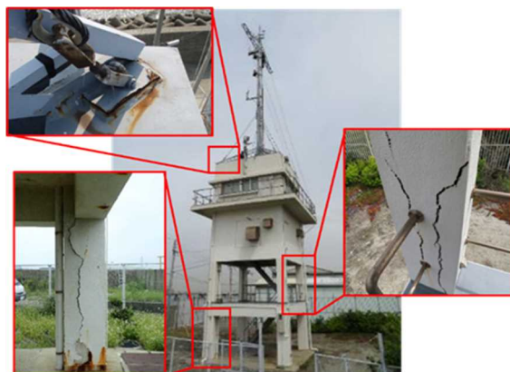
【(図表㉓) 老朽化した港内管制信号所】 [出典：海上保安庁]
