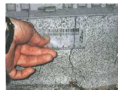
クラックスケールによる 基礎のひび割れ幅の計測
