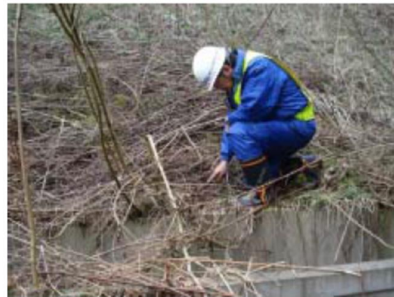
P3 下り線側のり尻 湿潤状況
